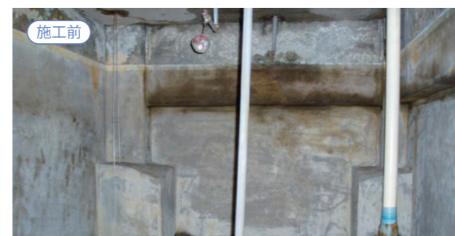
マンション受水槽
